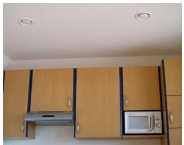
Abluftventile in der Decke
