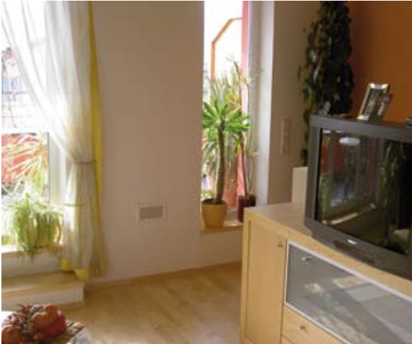
Zuluftöffnung in der Wand
